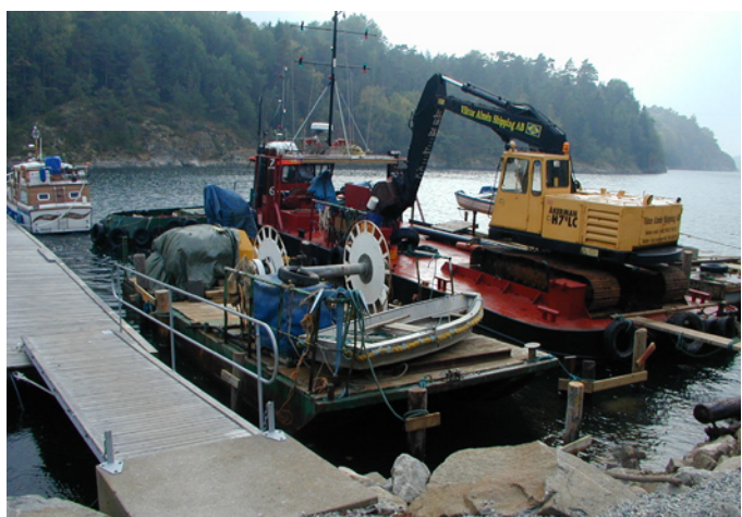
Just nu pågår anläggandet av en enklare kajkonstruktion i den västligaste delen av planområdets vattenområde.
