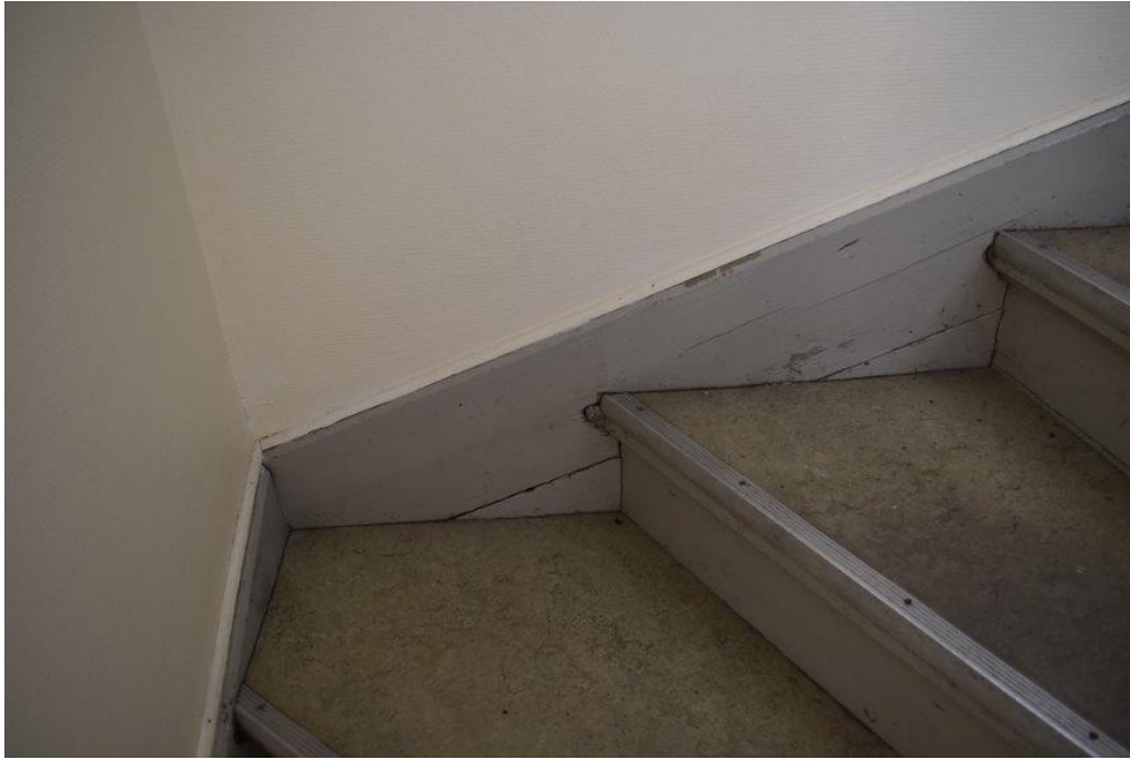
I byggnaden finns två trappuppgångar samt två källarnedgångar med synliga och bevarade trappdelar såsom vangstycke, sättsteg och stegnos. Plastmatta och aluminiumbeslag har lagts ovanpå trappstegen.
