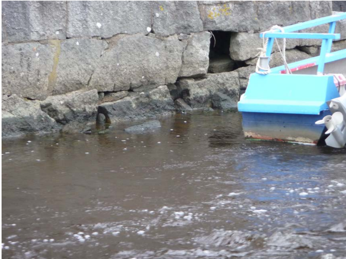
BILD 8. Skador närmast nedströms trappa
