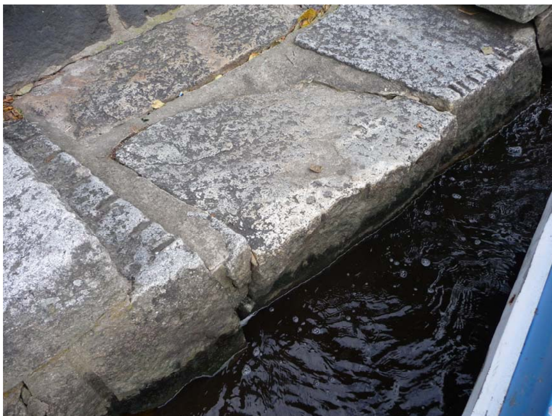
BILD 6. Sjunkt block med lagade fogar vid trappa
