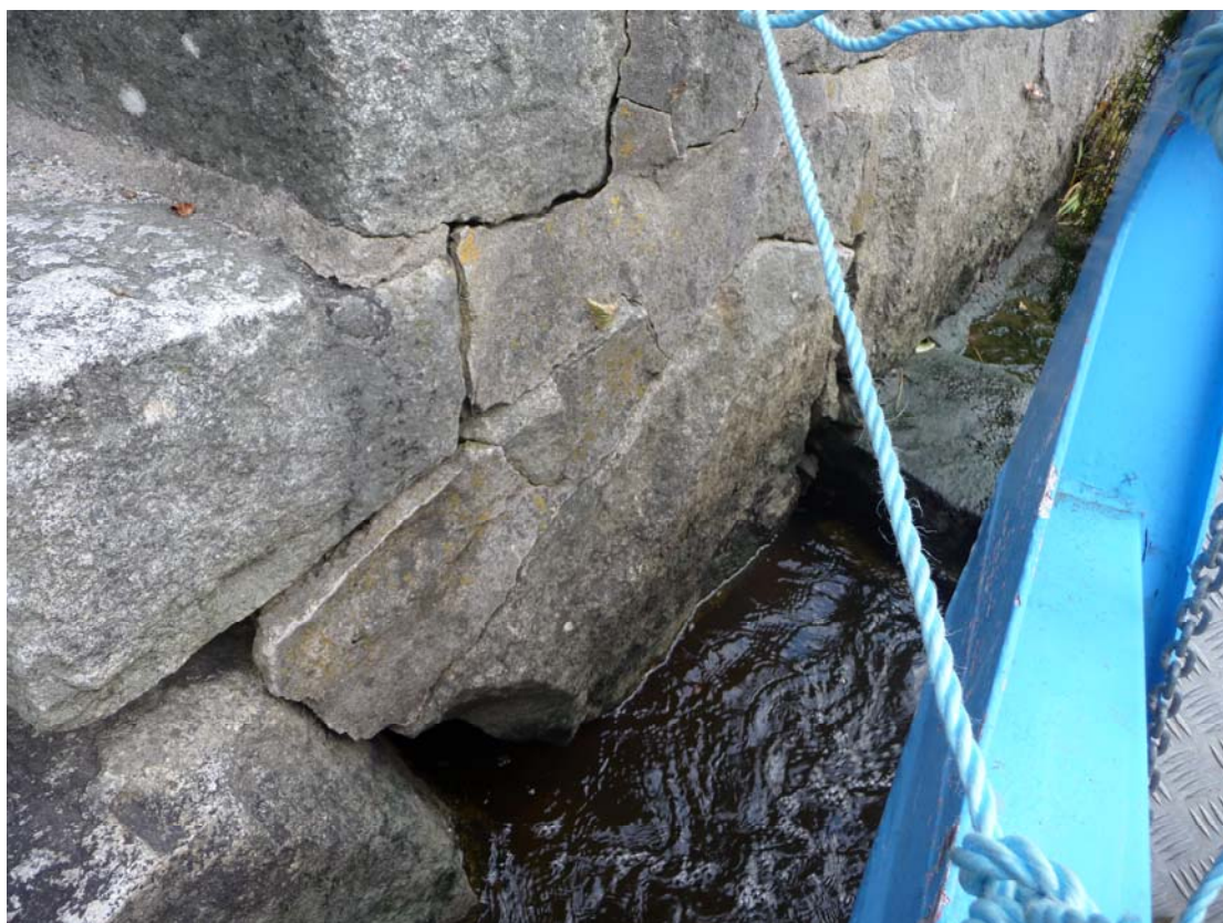
BILD 7. Sättningsprickor vid trappa
