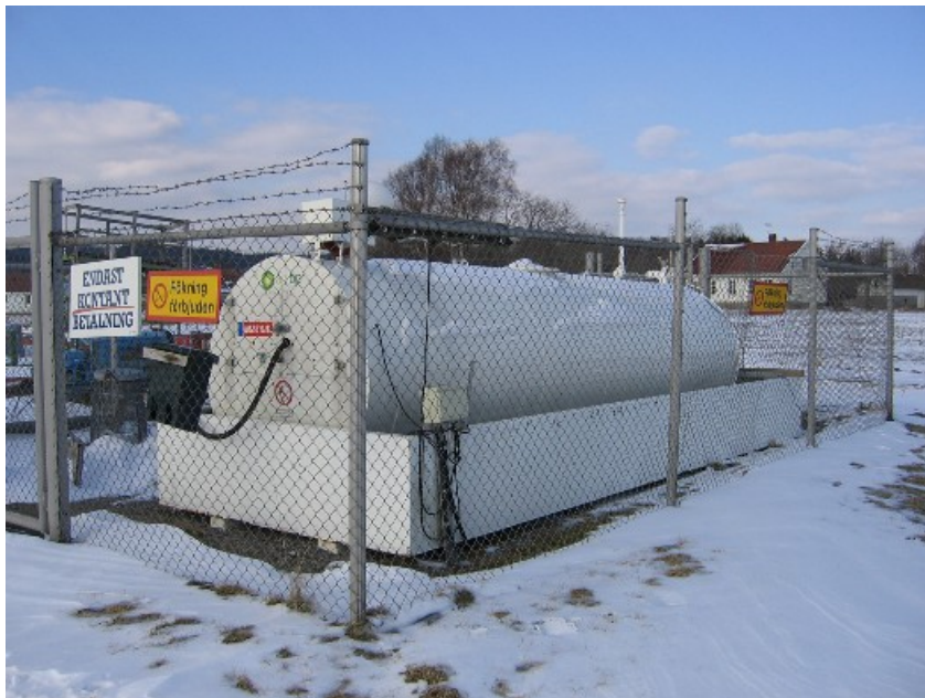
Nuvarande bränsleanläggning med invallning av drivmedelstanken
