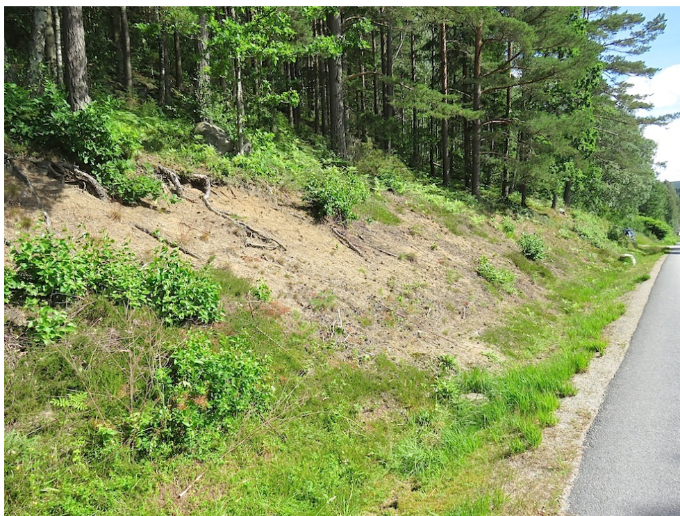
Element 5 i figur 2. Vägskärning med blottad sand.
