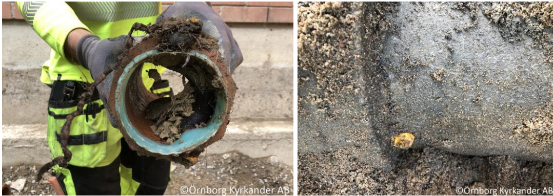
Figur 10. Två exempel på rötter som tagit sig in i rör via springor vid skarvmuffarna.
