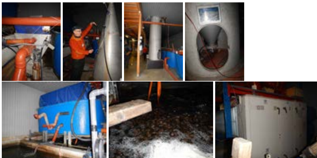
Figur 8. Rening i anläggningen. a) trumfilter, b) syrekon, c) dynasandfilter, d) avgasningsdel (blå) samt rörligt biofilter (MBBR) under, e) rörliga biofilter i närbild, f) ventilationsskåp. Foto: Anette Ungfors.
