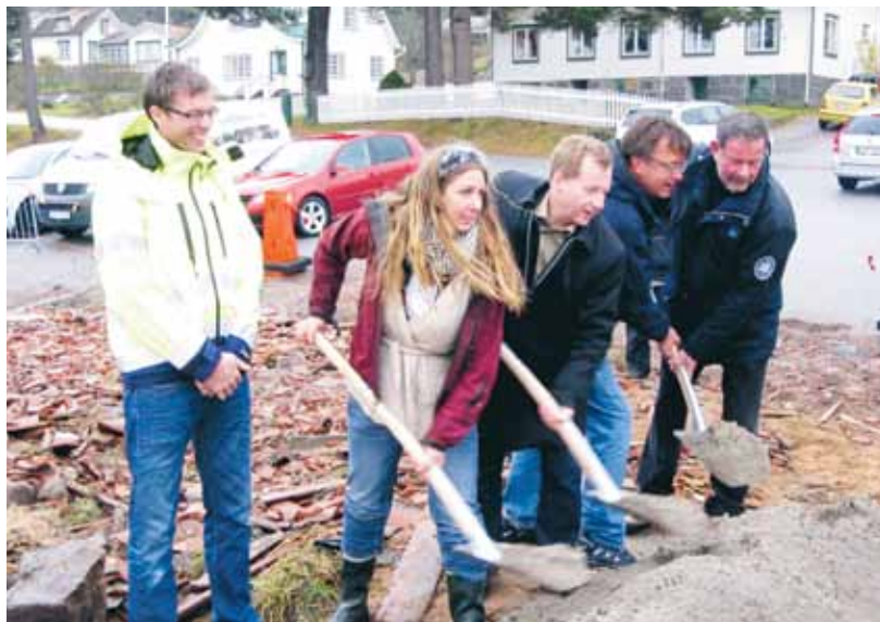
Spadtag för byggstart av nationalparksentré Rossö; Maria Kvarnback, Rossö samhällsförening, Ronnie Brorsson, Strömstad kommun, Anders Tysklind, Länsstyrelsen och Anders Bergquist, Naturvårdsverket. Projektchef Andreas Aronsson, Skanska, övervakar tilltaget. Foto: Ingvar Adamsson
